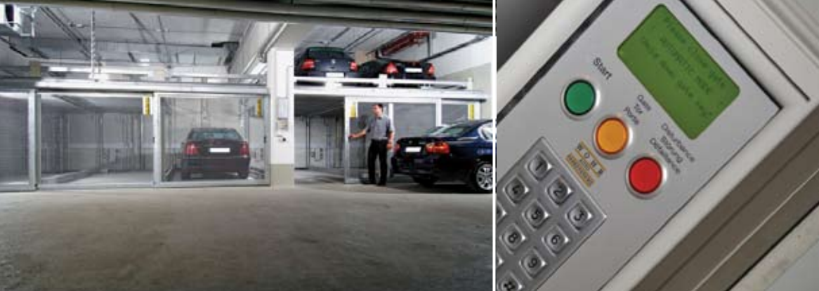
Sistema di parcheggio Combilift 543 per tre livelli di parcheggio ed una sola corsia di manovra in soli cinque metri di spazio verticale.
